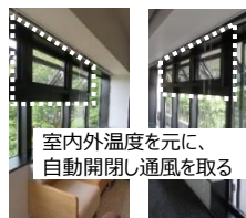
自動制御自然換気窓
